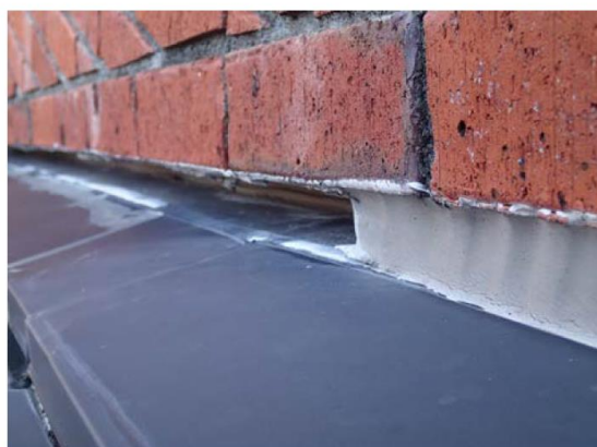
写真番号 29 種別 シーリング 細別 立上り水切り押えシーリングの欠陥
