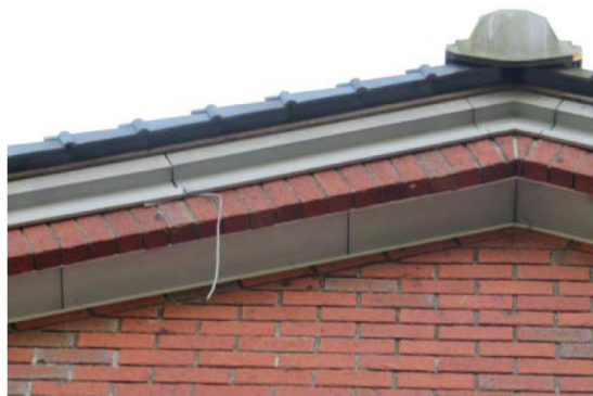
写真番号 19 (東面) 種別 シーリング 細別 笠木シールの剥離
