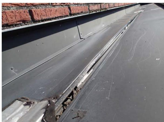
写真番号 27 種別 屋根 細別 アルミルーフ吊子キャップのはずれ
