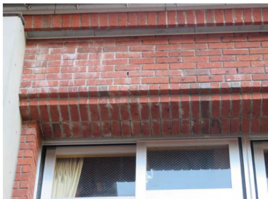
写真番号 17 (南面) 種別 外壁 細別 外壁レンガに白華 (全体的)
