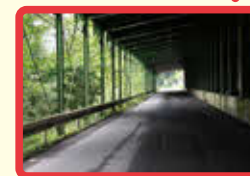
13 スノーシェード(道幅が狭く、路側帯がない。自転車通行時に大型車が通行すると危険)
