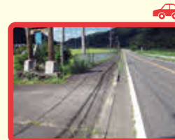
10 国道365号と合波橋の交差点(段差あり危険)
