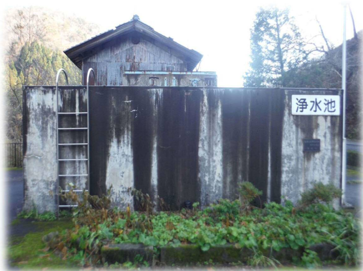
今庄・湯尾浄水場 浄水池
