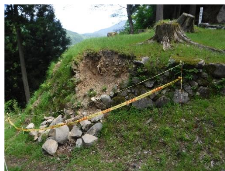
【崩落直後の状況】
