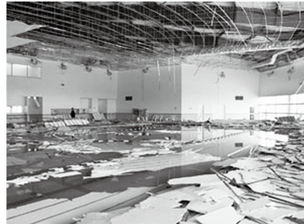
平成 17 年 8 月 16 日に発生した宮城県沖を震源とする地震。天井のパネルが落下したプール。
