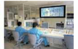
中央監視制御室
