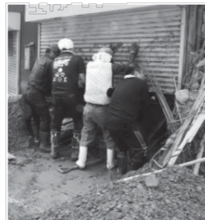
▲土砂により閉ざされたシャッターを開ける
