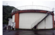
今庄・湯尾配水池
