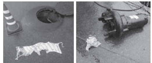
マンホールポンプ異物 衣類
